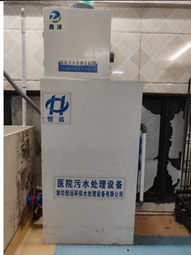
污水处理设施照片
